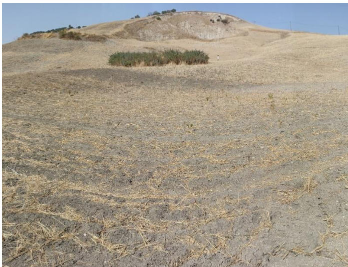
Photo 1 – Aspect de loin du glissement rotationnel au NE de Jebel Bou Zekri 22/08/2021
