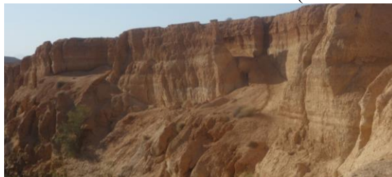
Photo 1. Glissement au bord de la falaise d'oued El Ard en aval du bassin d'oued El Abed. Le 17 septembre 2017
