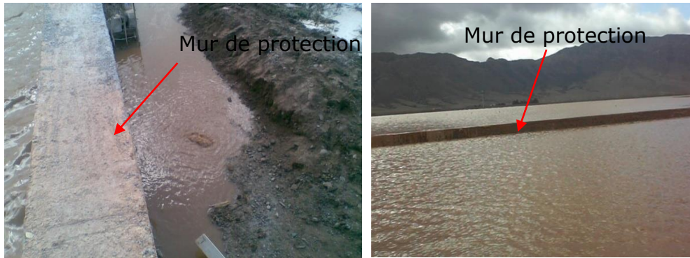
Planche photos 1. Destruction de mur de protection et submersion des zones protégées
