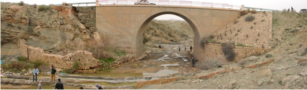
Photo 3. Le pont de l'oued Hammou vu de l'amont vers l'aval. Les réparations des dommages sur les méandres s'avèrent des fuites en avant, avec des interventions interminables.
