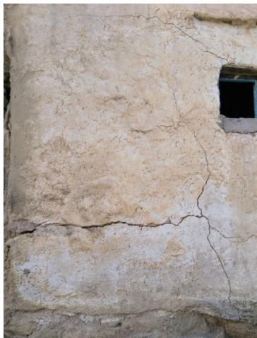
Fissuration murale intense postérieure aux tentatives de réparation
