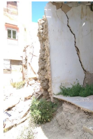
Effondrement des maisons dans l'ancien quartier
