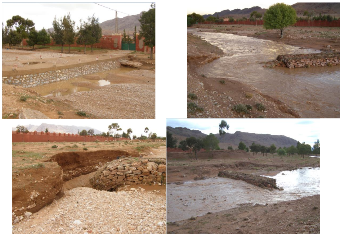
Photo 11-12-13-14. Les gabions censés protéger le radier, au nord de Bouarfa s'avèrent inutiles, voire nuisibles, car ils déstabilisent le lit et les berges, alors qu'ils sont édifiés pour « calmer » l'érosion.
